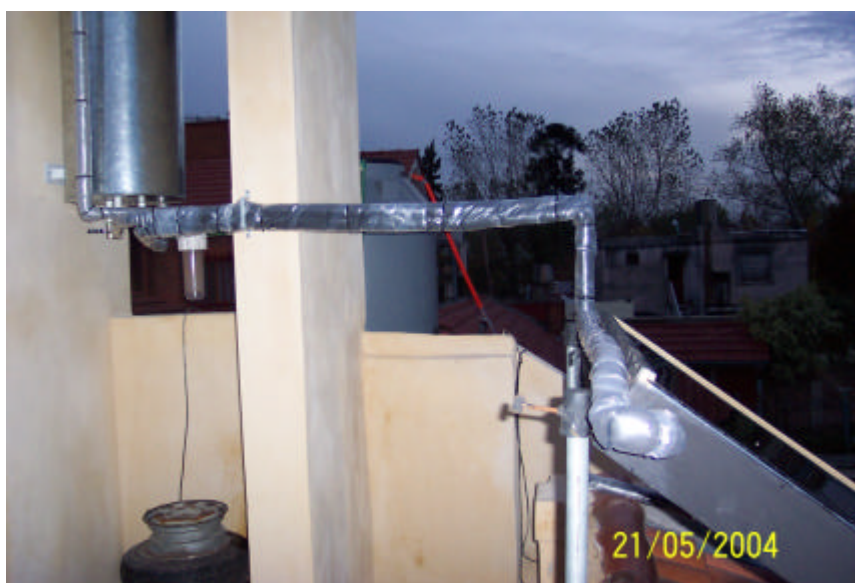
Sistema solar compuesto por colector solar plano & acumulador de calor
